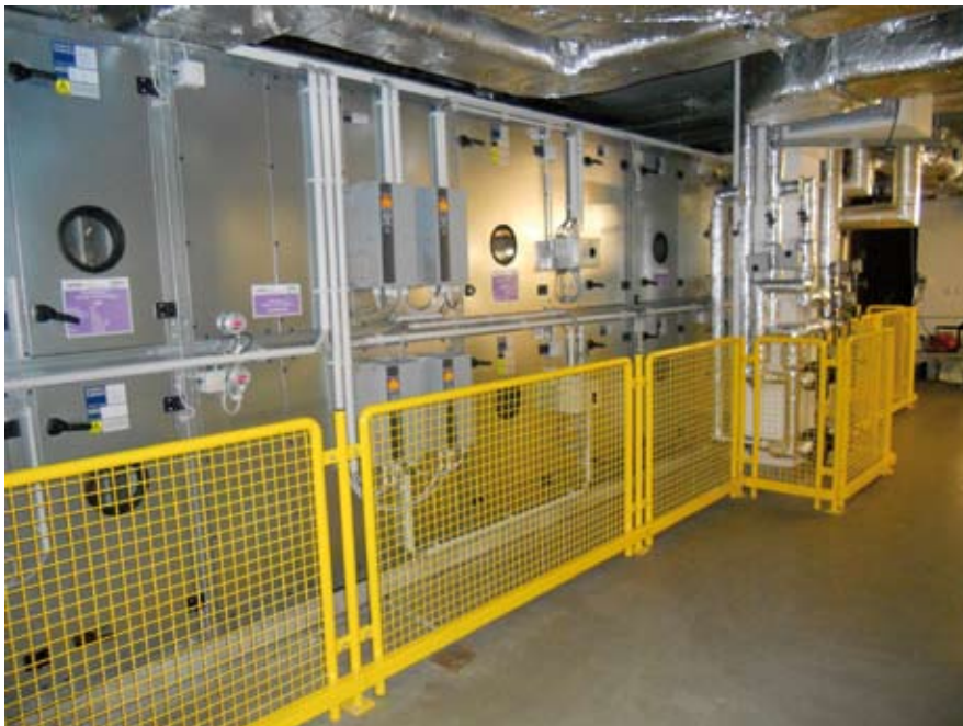
Neue energiesparende Duplexanlage
